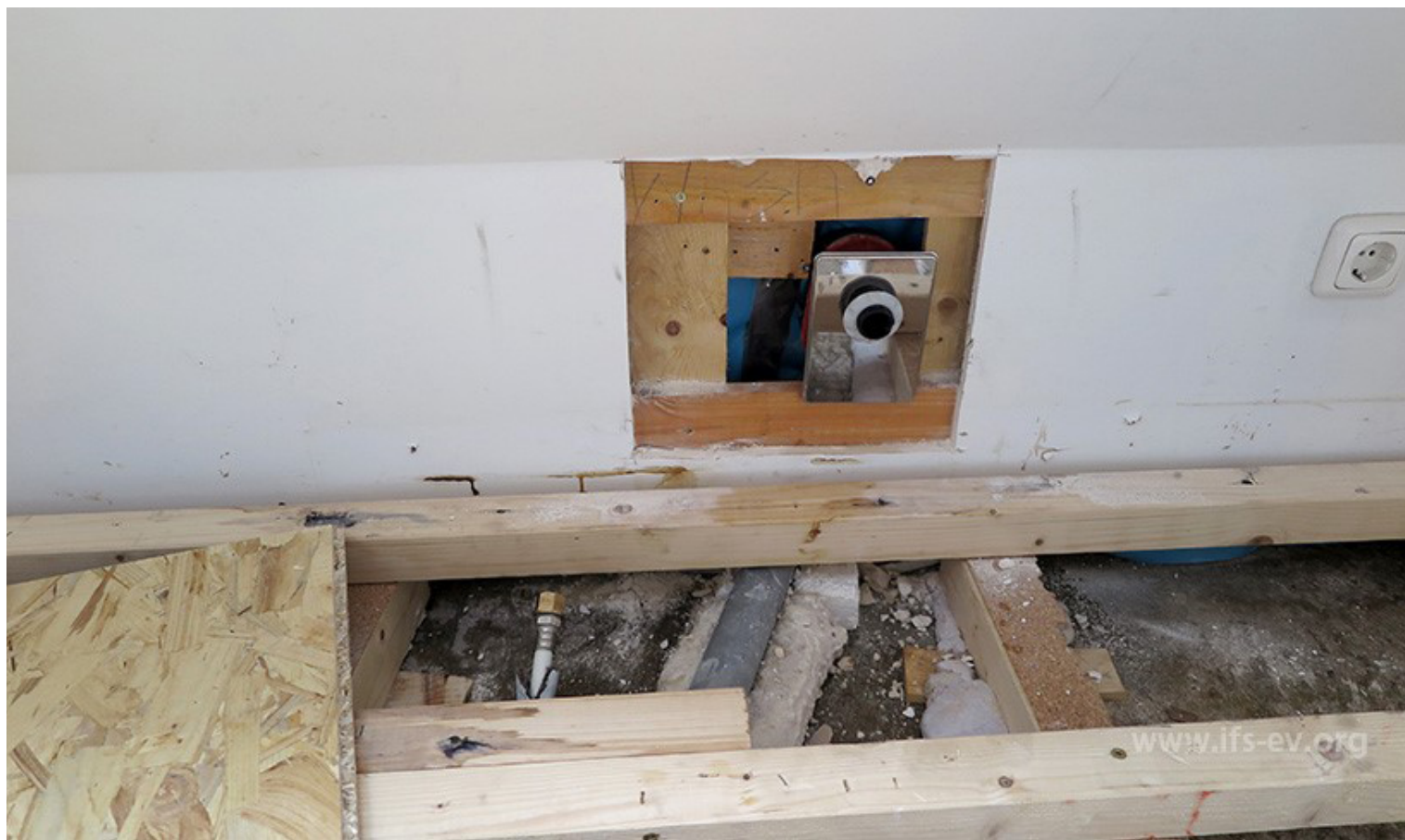
Die Anschlussleitungen für den Geschirrspüler verlaufen durch die Abseite. Foto: www.ifs-ev.org .
