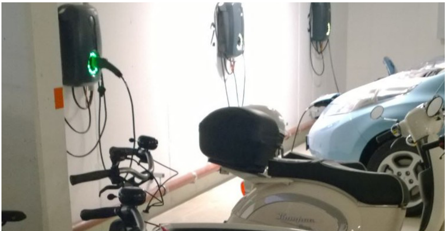
Ladeanschlüsse in der Tiefgarage. Foto: gw wohnungswirtschaft-heute
