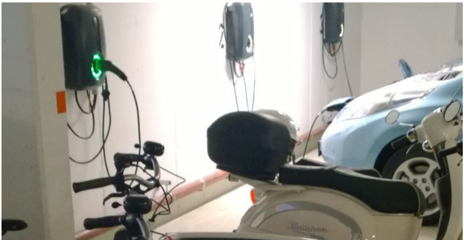
Ladeanschlüsse in der Tiefgarage. Foto: gw wohnungswirtschaft-heute
