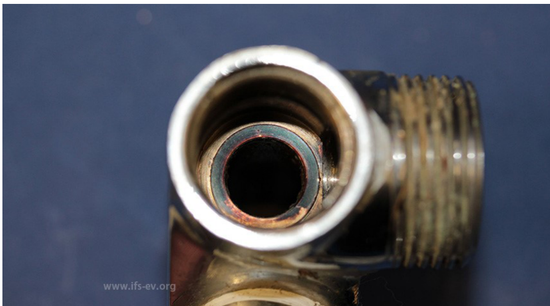
Der Dichtungssitz aus Messing ist nahezu vollumlaufend schwarz verfärbt. Hier hat die Dichtung „geklebt“. Foto: www.ifs-ev.org .
