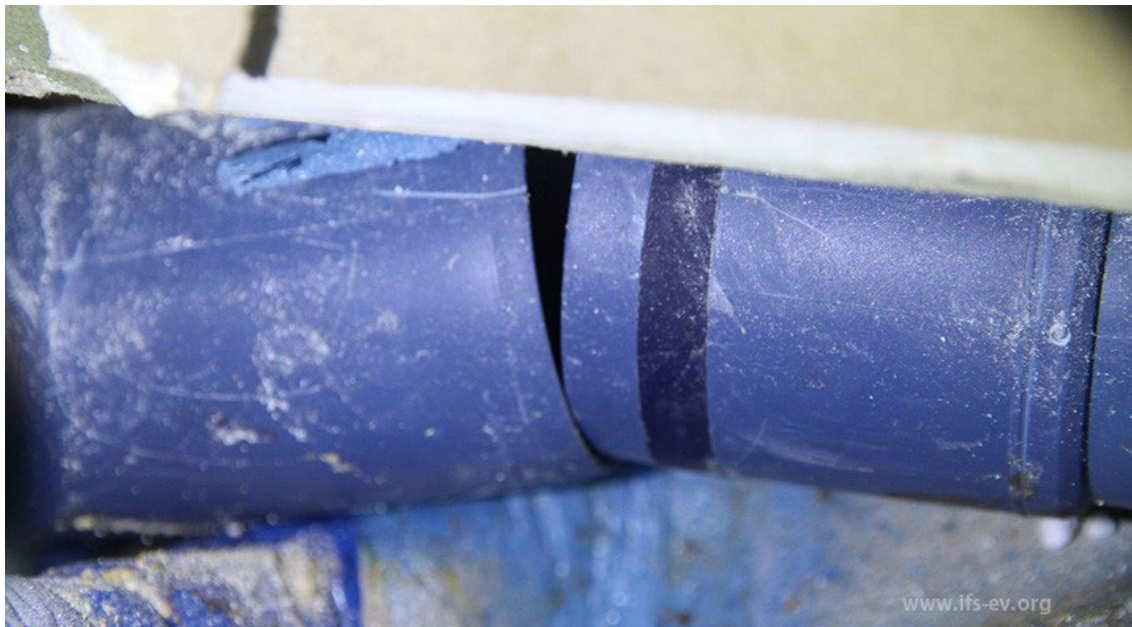
Die Steckverbindung im Abwasserrohr klafft auseinander. Foto: www.ifs-ev.org .
