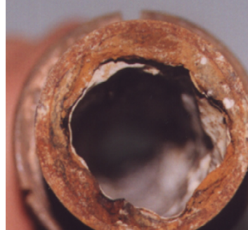
Bild 3: Ungenügende Reinigung der Innenwandung. Korrosionsprodukte sind zwischen dem Epoxidharz und der Metallinnenwandung gut erkennbar
