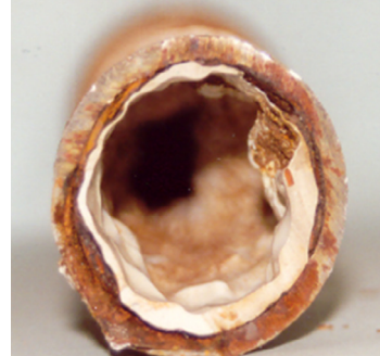
Bild 4: Deutlich erkennbar die unterschiedliche Beschichtungsdicke, oben (12-Uhr-Lage) wesentliche dünnere Epoxidschicht als unten in der 6-Uhr-Lage
