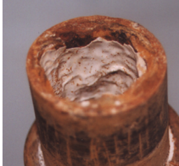
Bild 2: : Reales Rohrservat, verzinktes Stahlrohr nach einer Beschichtung aus einer TWI
