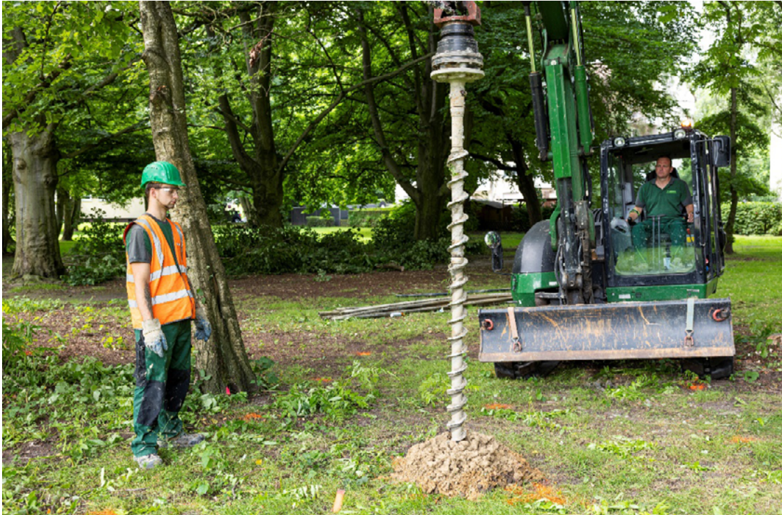
Christian Titt (im Bagger) und Tobias Aust von der Firma Röhll Kampfmittelräumung kümmern sich um die professionelle Bombenräumung. Foto: Vonovia / Kreklau
