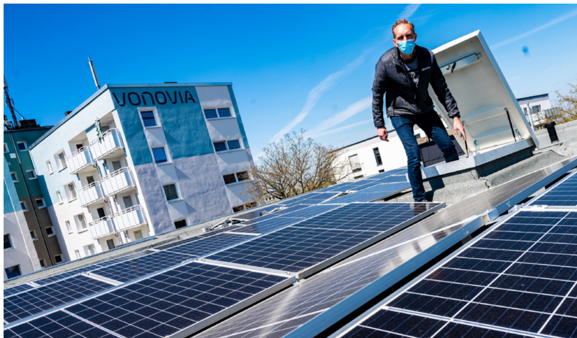
Vonovia setzt verstärkt auf erneuerbare Energien wie Photovoltaik. Foto: Vonovia
