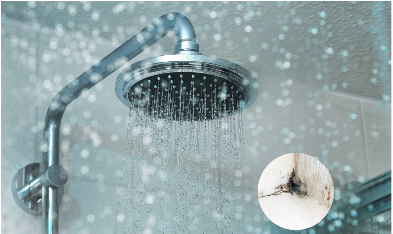
Ein Grundproblem: zu hohe Luftfeuchtigkeit in der Wohnung und besonders in der Dusche. Foto: DEKRA
