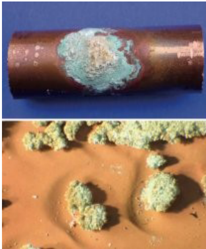
Die Außenseite des Kupferrohres (oben) ist mit Korrosionsprodukten belegt, während sich innen Erosionskorrosion zeigt (unten).
