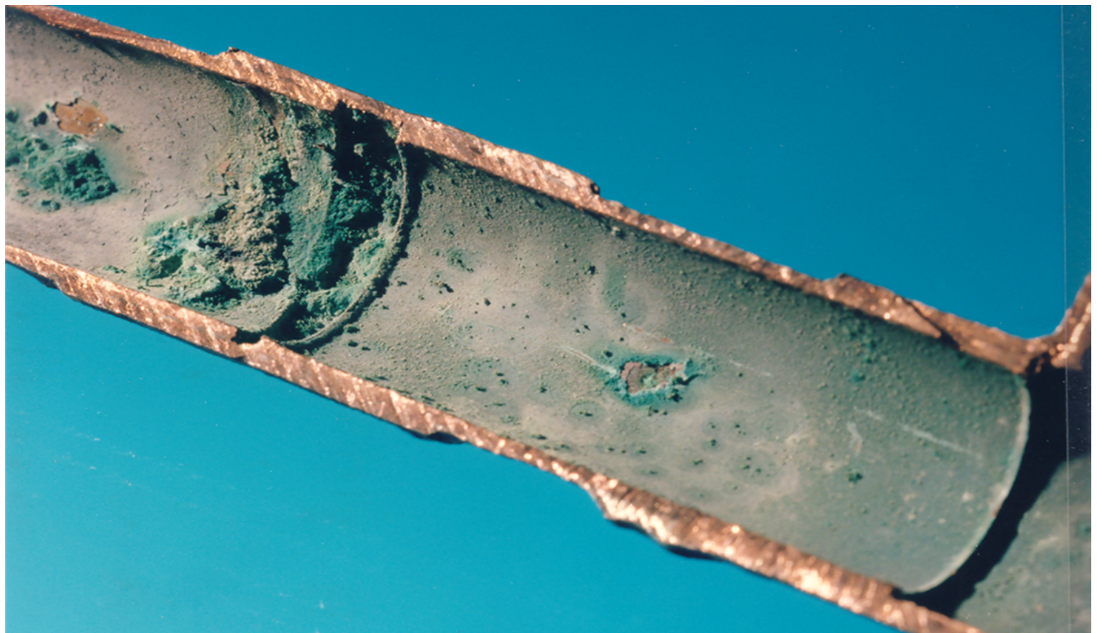
Bild 2: Kupferrohr mit Korrosionsangriffen an den nicht entgrateten Stellen durch die Ausbildung von sogenannten Belüftungselementen. Die homogene Deckschicht fehlt. Bildquelle: Christoph Gies, Dinslaken
