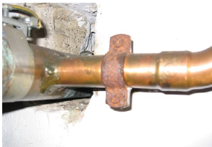
Bild 1: Kupferinstallation mit verzinkter Stahlschelle
