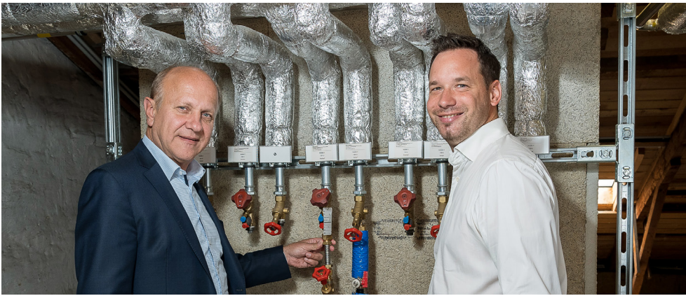
Die Sozialbau setzt auf Gemeinschaftsthermen, um CO 2 und Kosten zu sparen – zum Beispiel in der Anlage in der Miesbachgasse in Wien (links im Bild: Ernst Bach mit einem Energieexperten).
