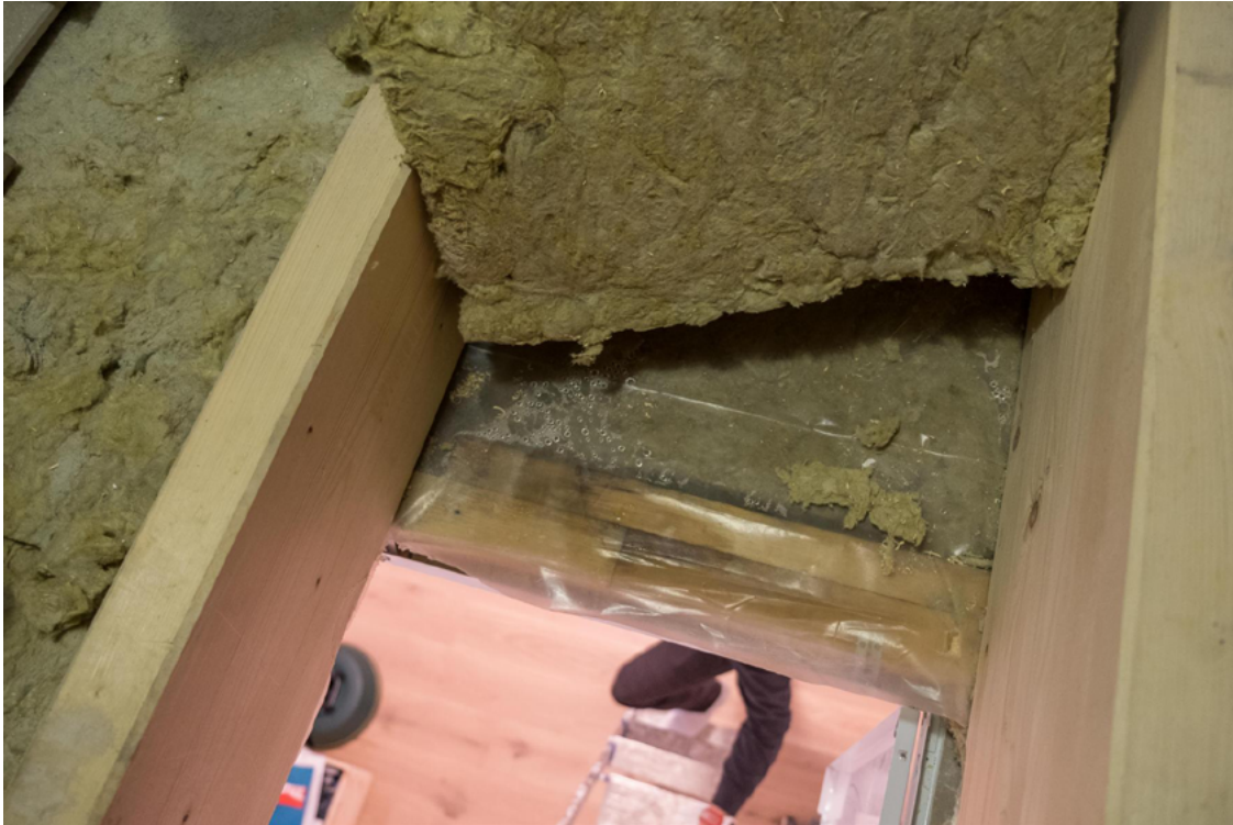
Abb. 1: Fehlerhafte Ausführung der Dampfbremse an der Holztramdecke
