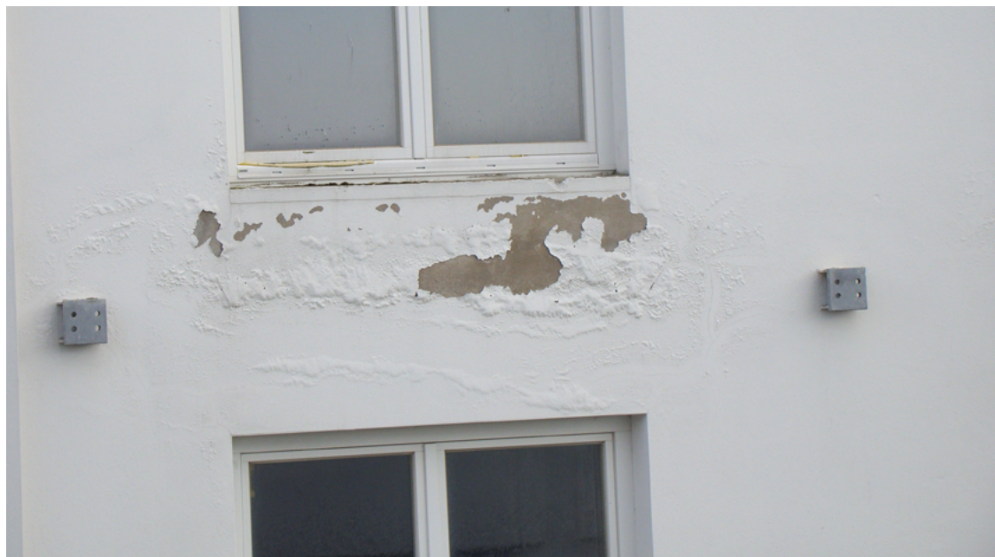
Feuchteschaden an der Außenwand. Foto: Gerd Warda
