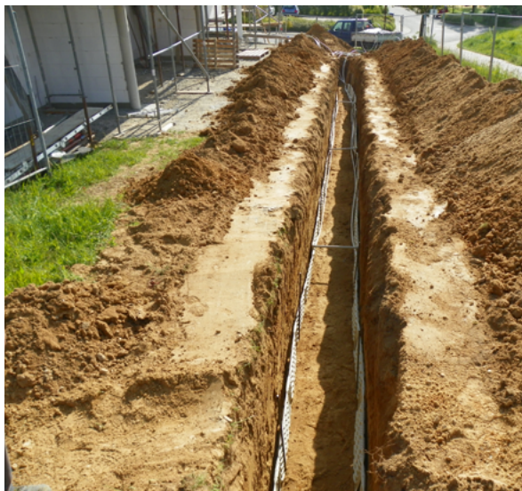
Erdwärmeabsorber, insgesamt 18 Stränge mit einer Gesamtentzugsleistung von 18 kW im Erdreich versorgen die Wärmepumpe. Foto: Geocollect
