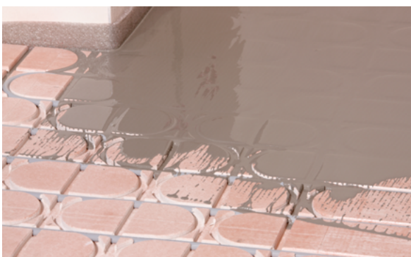
Rohrsysteme in Dämmplatte mit Nassestrich
