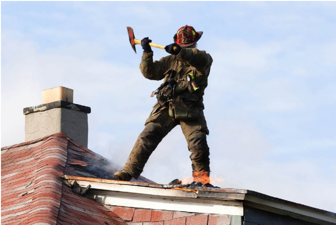
Brandbekämpfung Dach; Foto Solaredge
