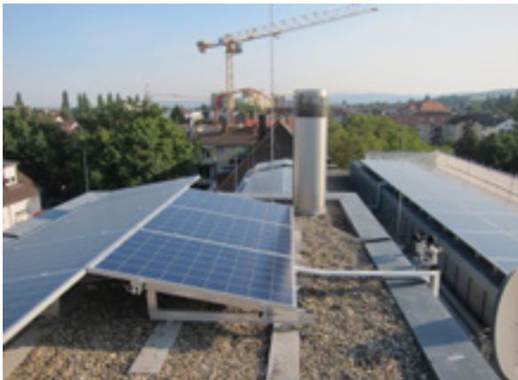
PV-Dachanlage Verwaltungsgebäude; Foto Bauverein Breisgau
