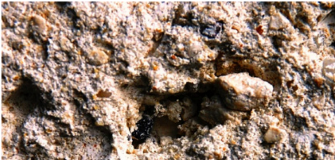
Schadensbild; Foto Zielke-VHD
