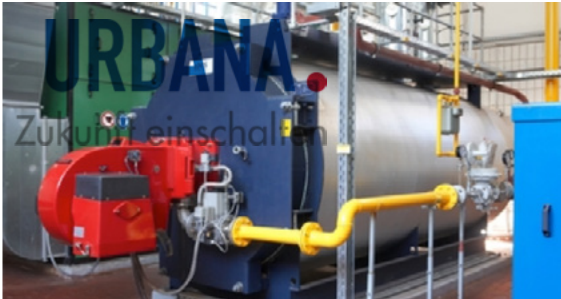
Blick in ein Heizwerk
