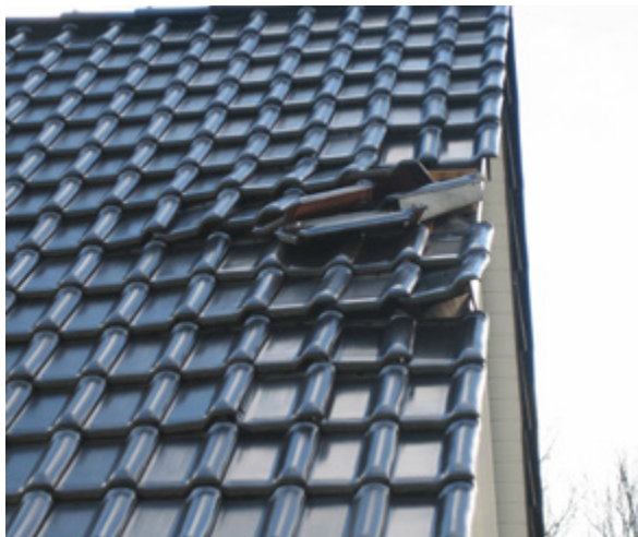
Sturmschaden Steildach; Foto FOS
