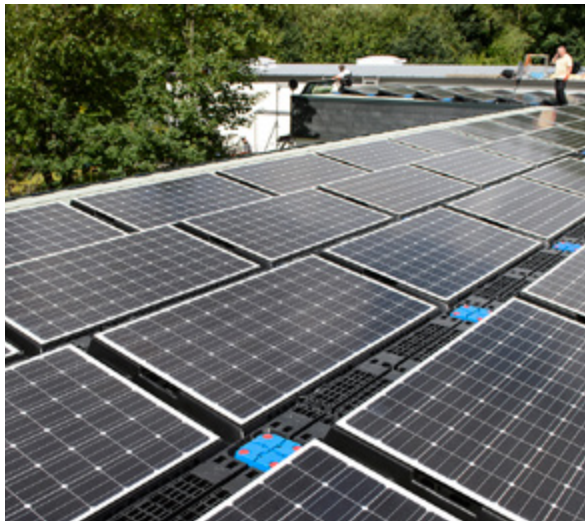
Solaranlage auf Flachdach
