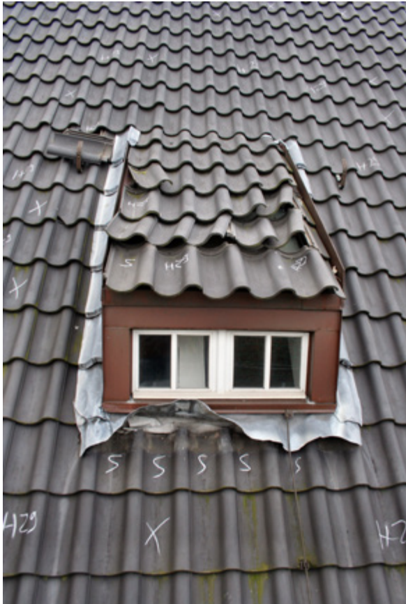
Gaube mit Markierungen Schadensbereich
