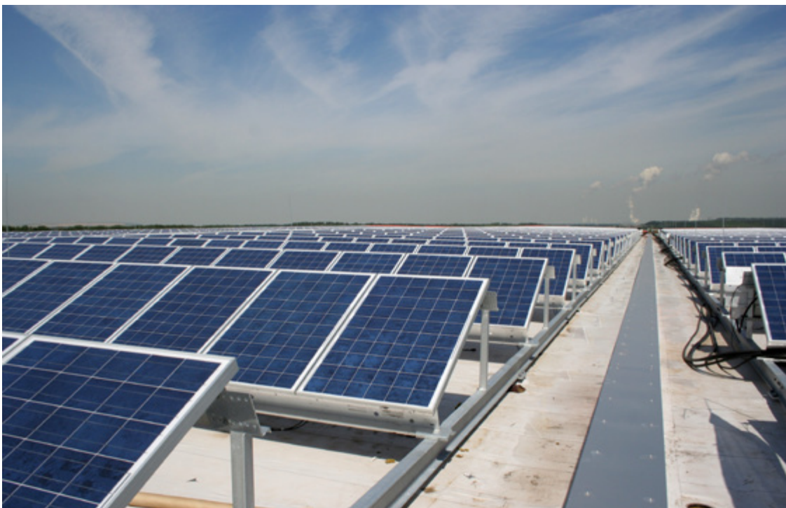
Hallendach PV-Anlage; Foto Krolkiewicz
