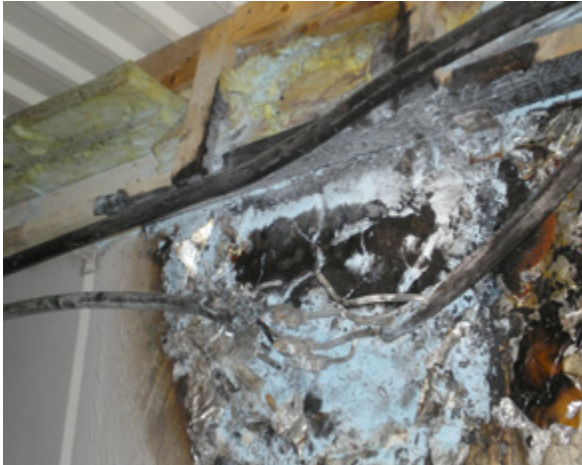
Brand durch falschen Kabel (Aluminium); Foto VGH
