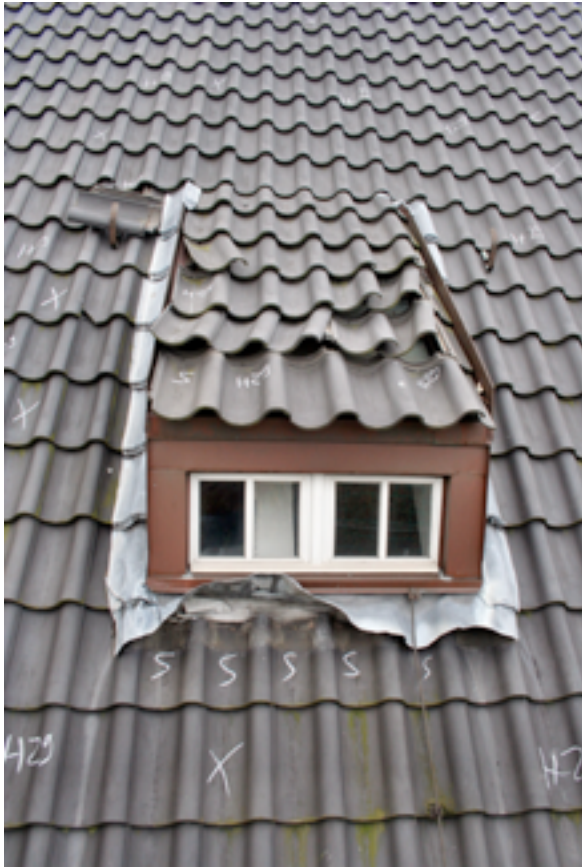
Gaube mit Markierungen Schadensbereich
