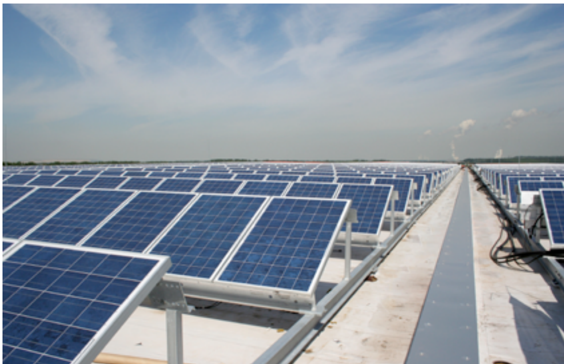
Hallendach PV-Anlage; Foto Krolkiewicz
