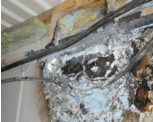
Brand durch falschen Kabel (Aluminium); Foto VGH
