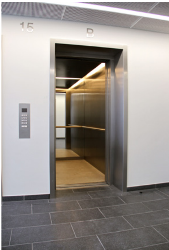
Aufzüge zertifizieren; Foto Schindler
