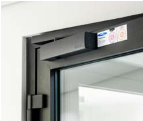
regelmäßige Wartung Feuerschutztür
