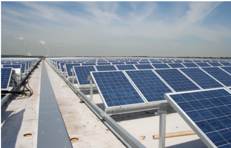
Hallendach PV-Anlage; Foto Krolkiewcz
