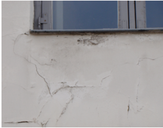
Denkmal Feuchteschaden Fassade
