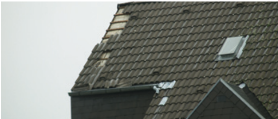
Luftwirbel greifen unter die Dachziegel, Fotos privat
